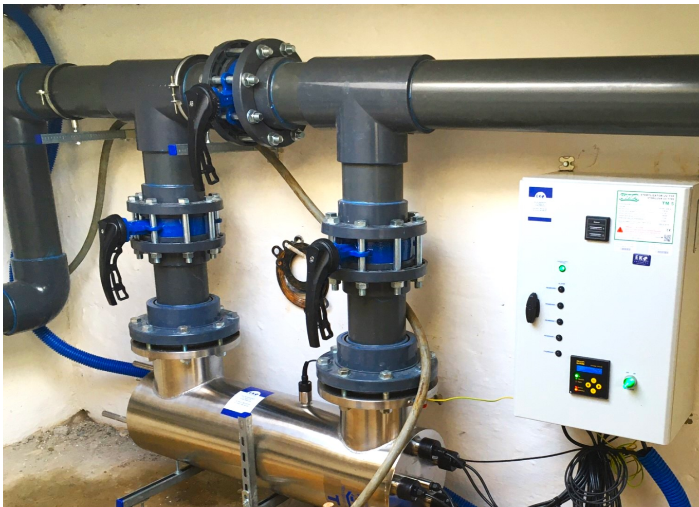
Lampa UV Pompownia nr 1 ujęcie Radzików II
